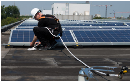
Kabelsystemen voor valbeveiliging moeten op minimaal 2 meter van de dakrand staan.
